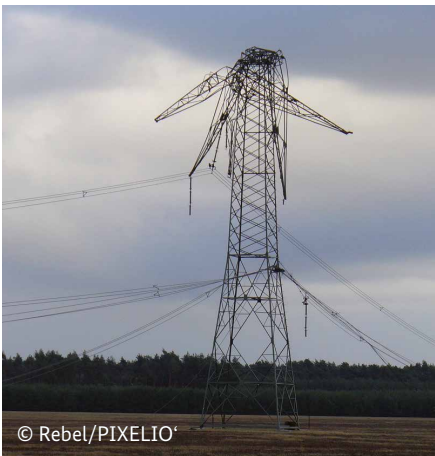
Sturmschaden durch den Orkan Kyrill im Jahr 2007
